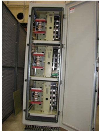
GE SSPS, 1 MW
